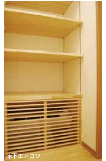
床下エアコン
