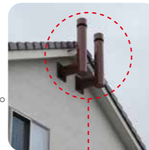
ここがポイント！ パッシブ換気換気システムの排気口。
